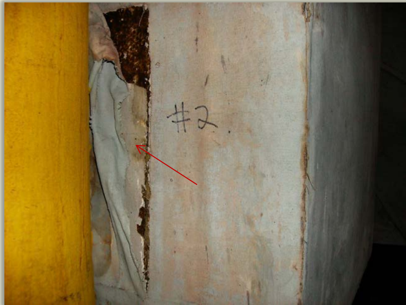
Parging cement on ductwork – Van Vliet East
